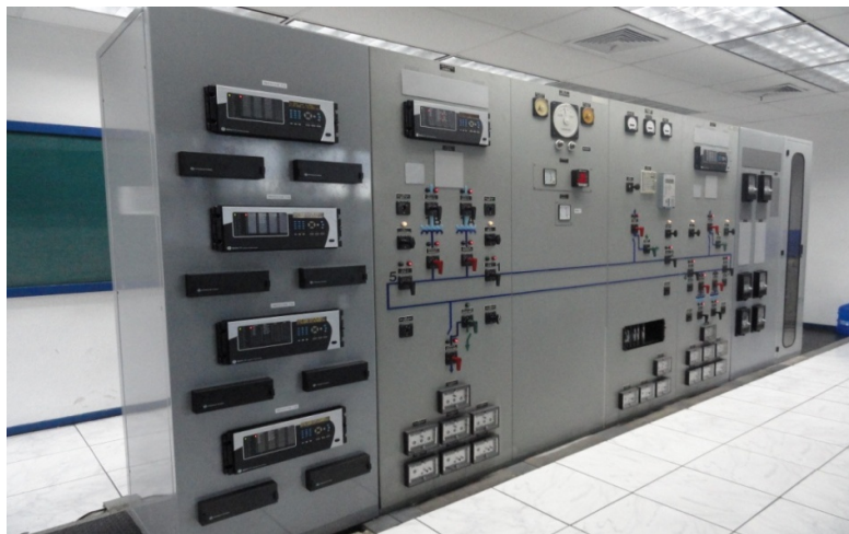
Figura 1.8 Tablero de protecciones
