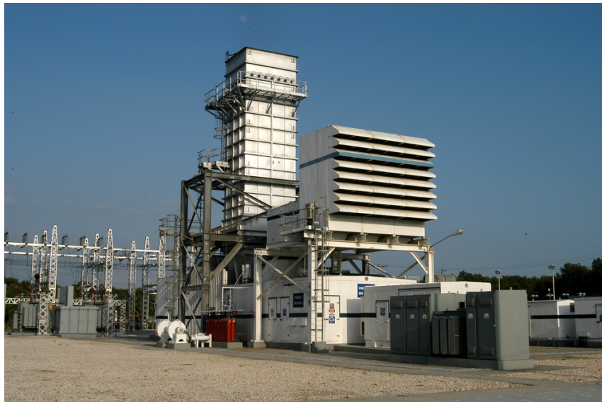
Figura 1.4 Turbina a Gas Nº 2 MS6001B
