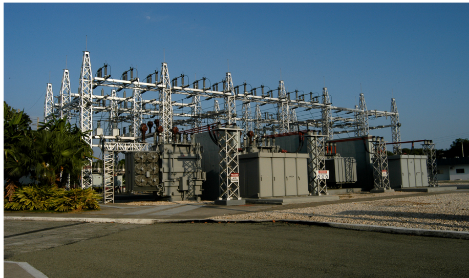
Figura 1.6 Subestación de Elevación
