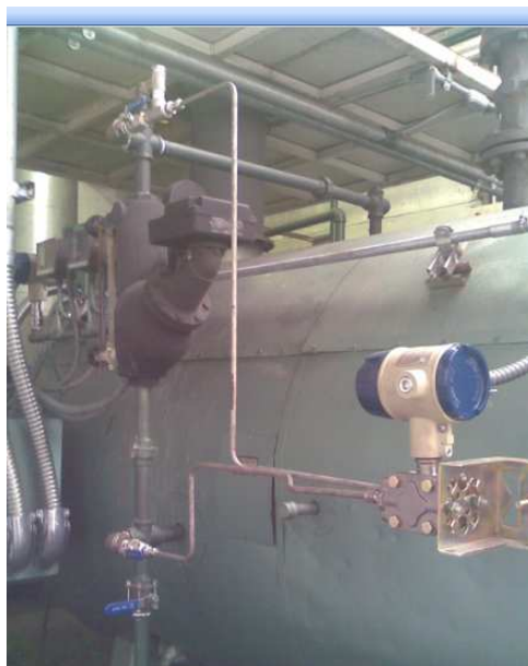
Transmisor de presión diferencial Honeywell ST3000 para medir Nivel del agua
