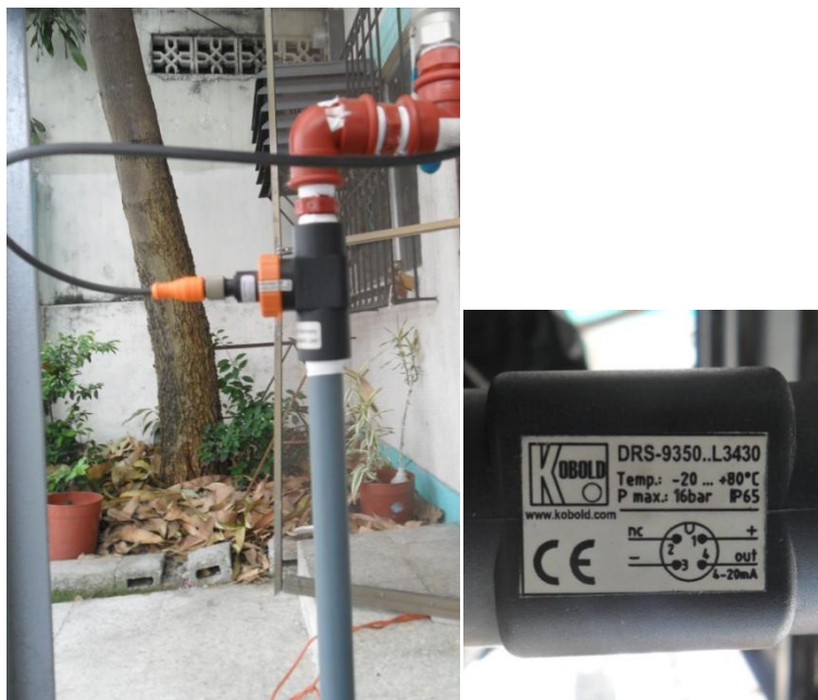
Figura 26.- Sensor de caudal.
