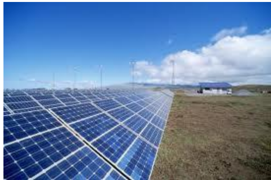
Figura 2.1: Bloque de paneles fotovoltaicos.
