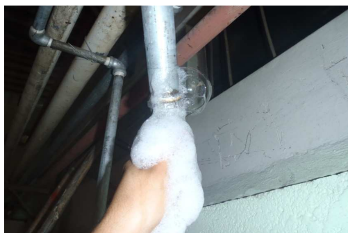
FIG. 3.11 FUGA DE AIRE COMPRIMIDO EN LA LÍNEA
