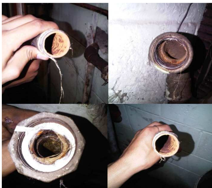
FIG. 2.14 TUBERÍA DE AIRE COMPRIMIDO ACTUAL EN LAS ÁREAS DE TERMOFIJADORA Y FAK
