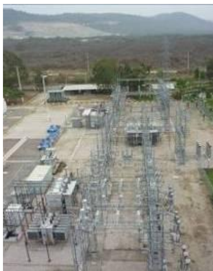
Fig.1.V. Subestación de 69/138 KV
