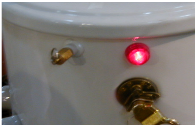
Figura 4.10. Breaker y luz piloto accionada.
