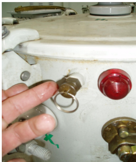
Figura 2.3. Válvula de sobrepresión accionada por sobrecarga del transformador
