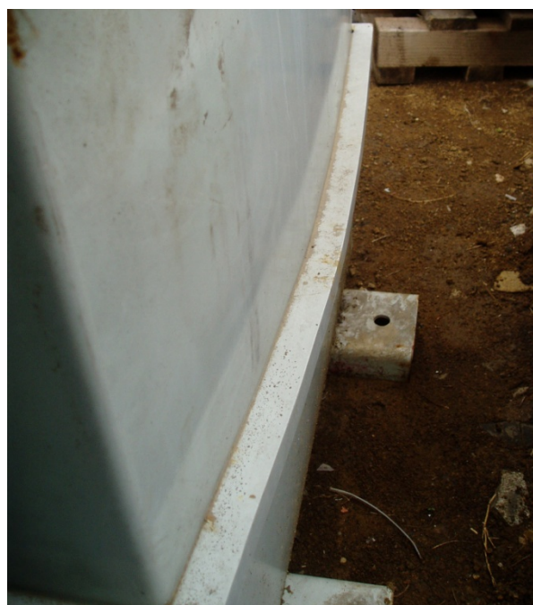
Figura 2.4. Tanque de transformador deformado por falla de accionamiento de válvula de sobrepresión.
