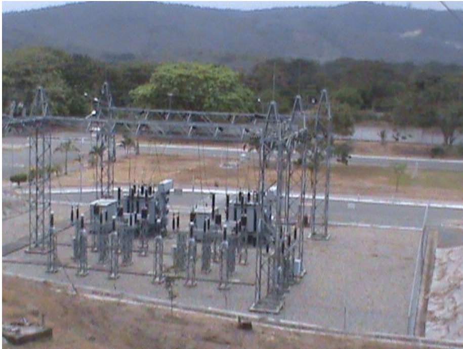
Fig. Sistema eléctrico de la subestación La Toma (Interagua)
