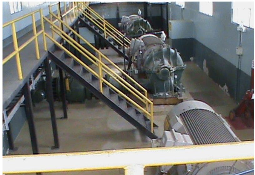
Figura 1.6. Motores trifásicos (Estación de Bombeo3)
