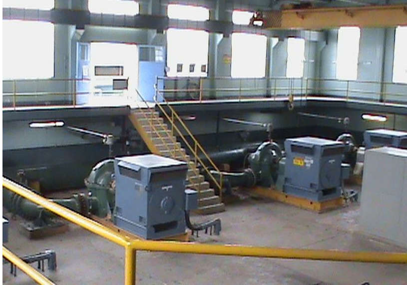
Figura 1.3. Motores trifásicos de 1250 HP, 4160 V, 160 A
