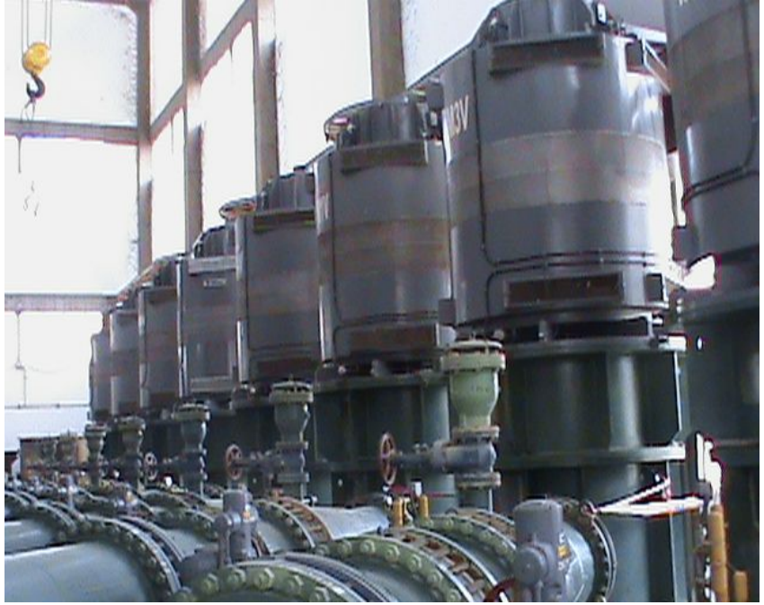
Figura 1.1. Motores trifásicos de 3000HP, 13800 V, 116 A
