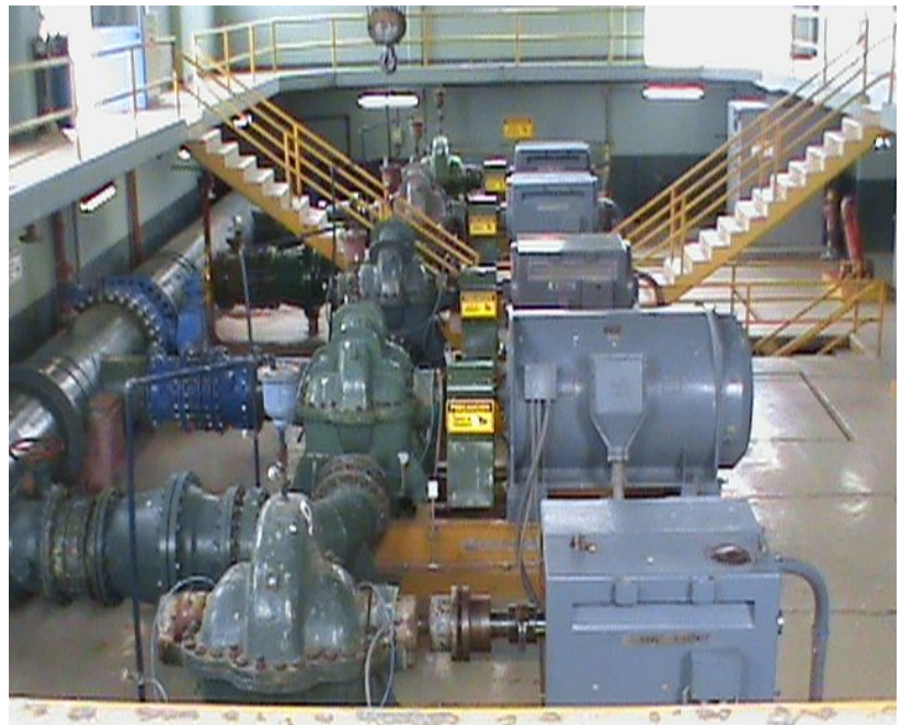
Figura 1.5. Motores trifásicos (Estación de Bombeo2)
