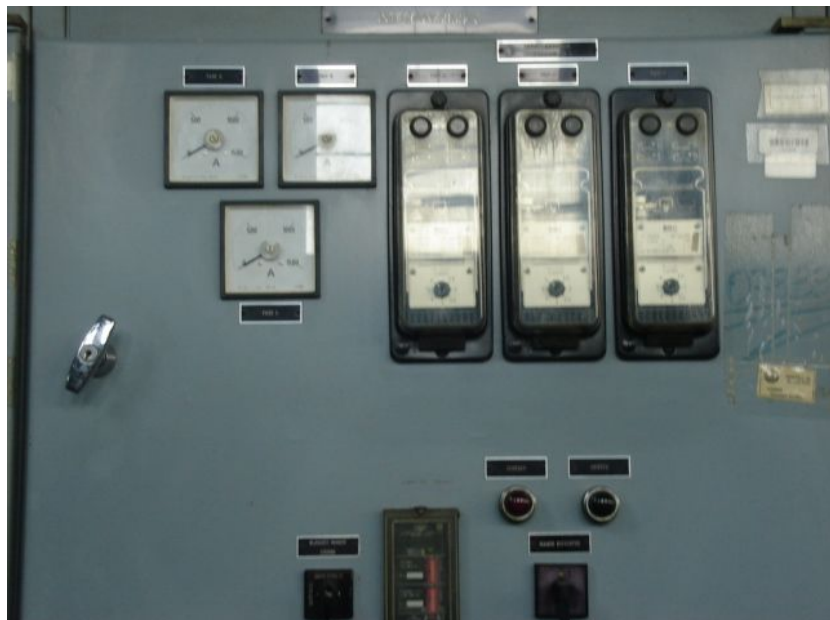
Figura 1.4. Protecciones analógicas de sobre corriente del interruptor general de entrada a EB1
