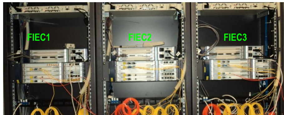
Figura 4.5 Equipos OSN 1500B del laboratorio de Telecomunicaciones.
