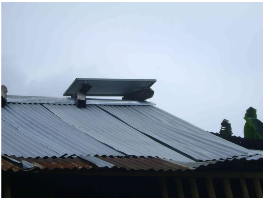
Figura 48.- Ubicación del panel solar
