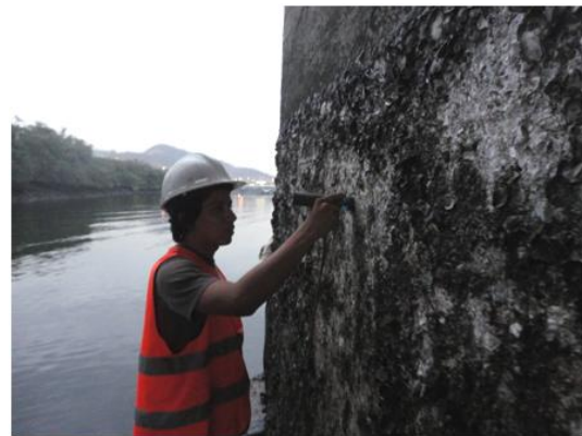
Figura 5. Colocación del sensor B en el punto de medición
