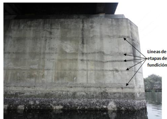
Figura 6. Líneas de etapa de fundición en la pila 2
