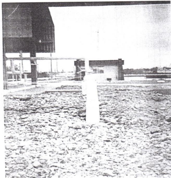
FIGURA 3.13. Enterramiento de tubería de 8" en área de la Estación de Bombeo Tres Bocas.
