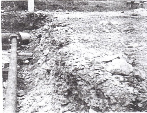
FIGURA 2.3. Tubería recubierta con pintura afectada por diferentes capas de terreno.
