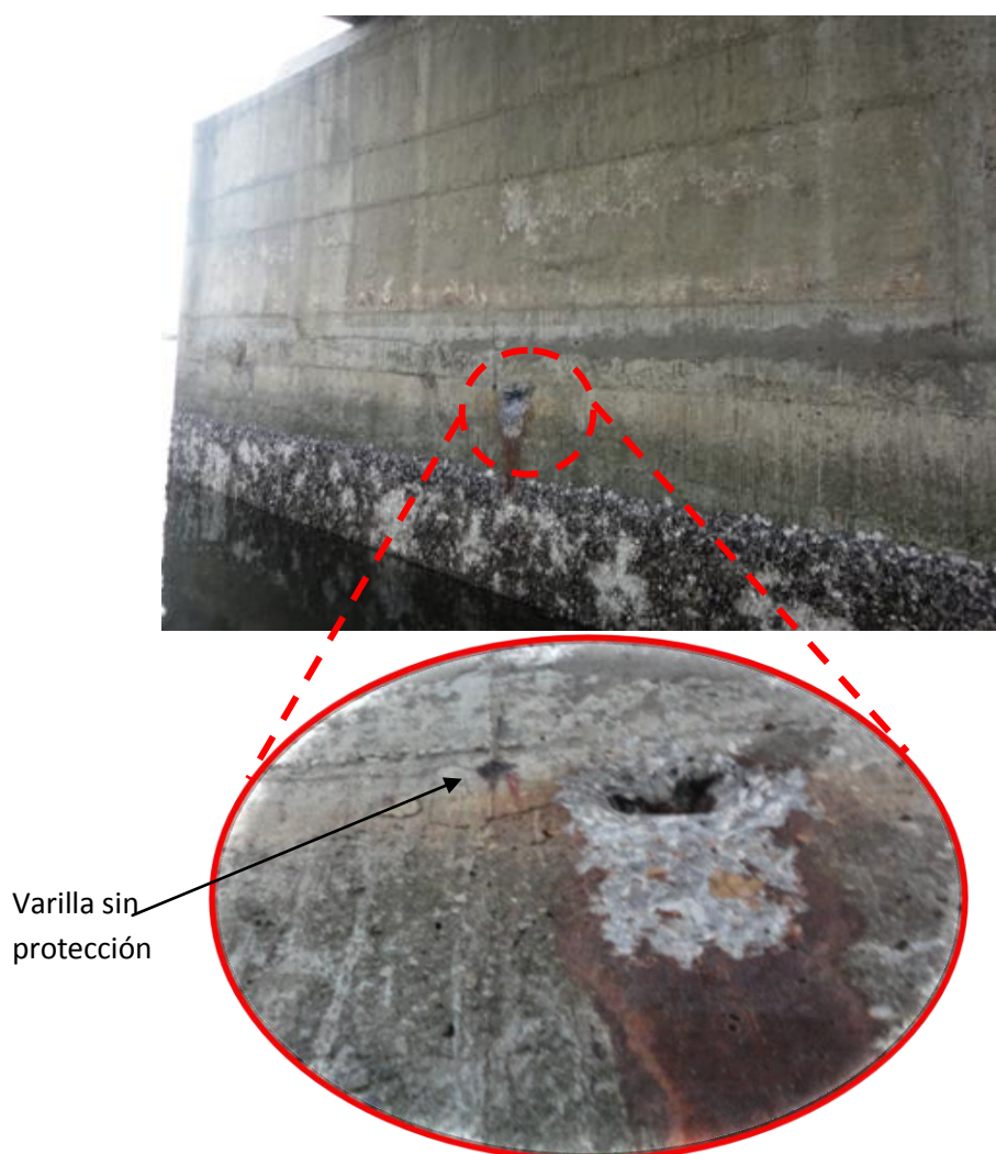
FIGURA 3.8 – ROTURA DEL HORMIGÓN (FOTO P1-LP ENTRE E2 Y F2)
