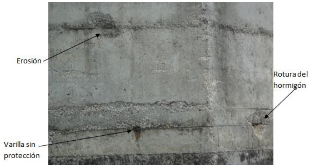
FIGURA 3.13: DESPRENDIMIENTO DEL HORMIGÓN Y CORROSIÓN EN LAS VARILLAS (FOTO P2-LM-G2)
