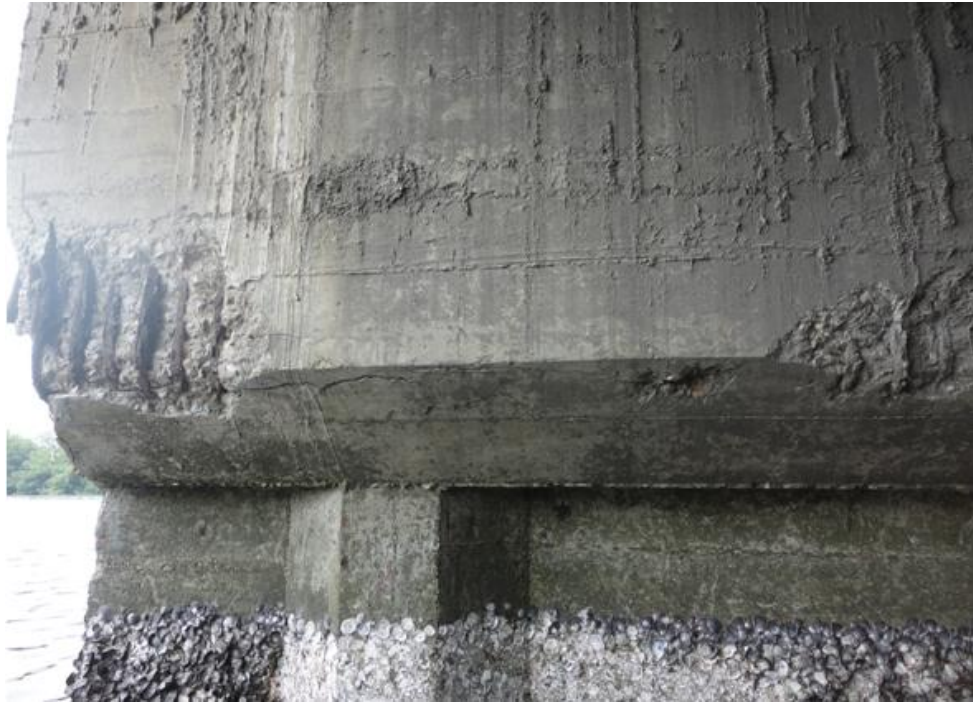
FIGURA 3.18: DESPRENDIMIENTO DEL HORMIGÓN (FOTO P4-LM-A1)
