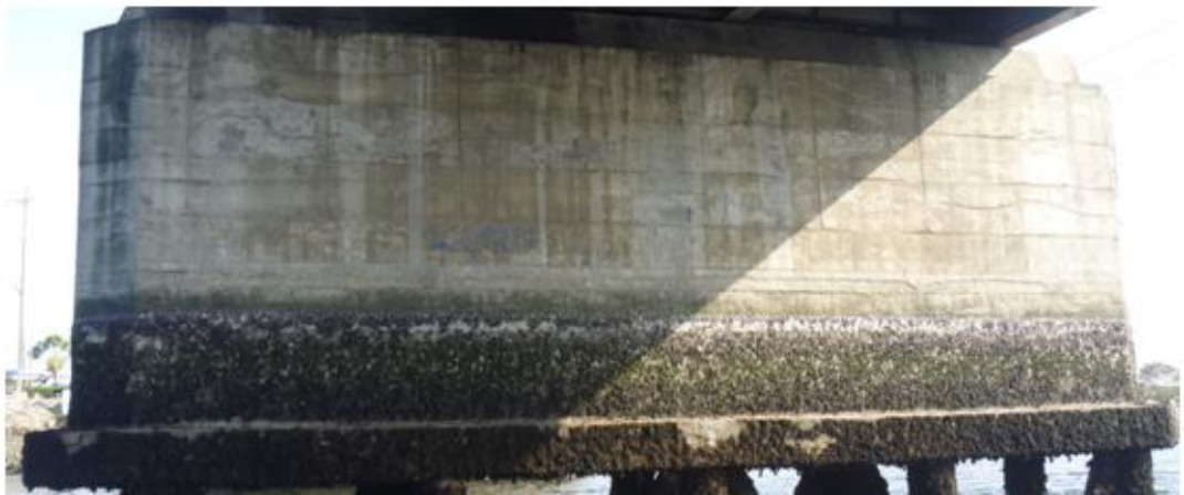
FIGURA 3.7: FOTO DE LA PILA 2 LADO PJ CON PRESENCIA DE MOLUSCOS HASTA UNA ALTURA DE 1.8 M
