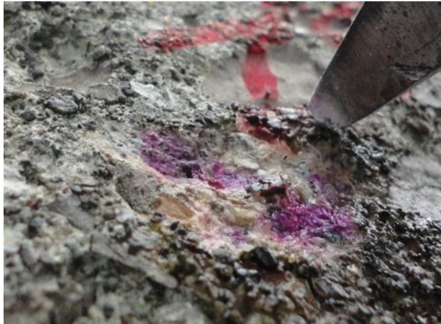
FIGURA 3.20: FOTO DE LA MEDICIÓN DE PROFUNDIDAD DE LA CARBONATACIÓN EN P3-LP-B2
