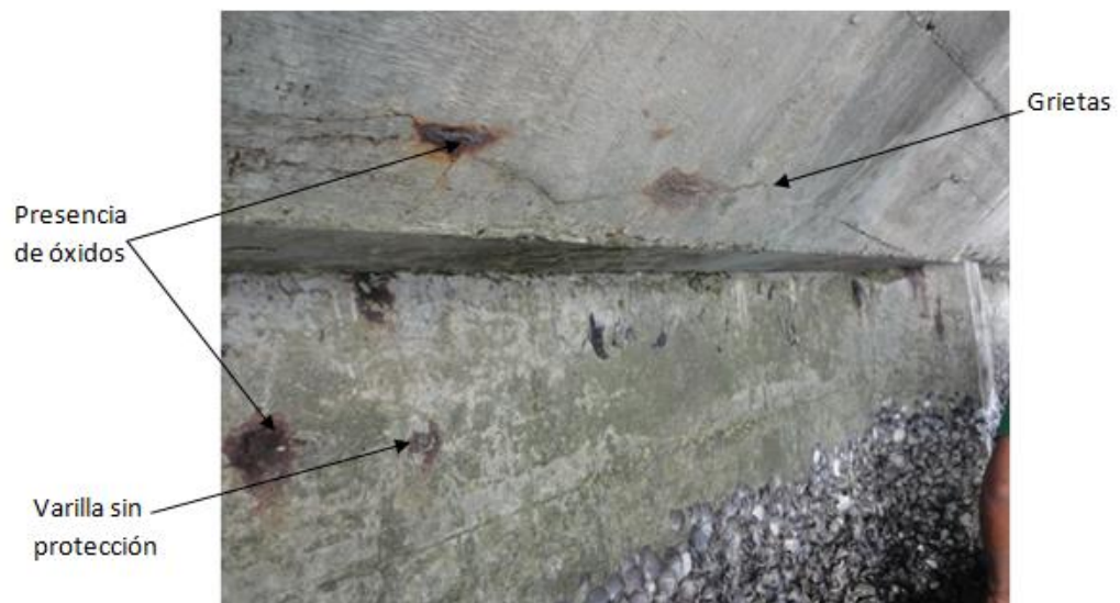
FIGURA 3.17: PRESENCIA DE CORROSIÓN (FOTO P4-LP ENTRE E1-F1)
