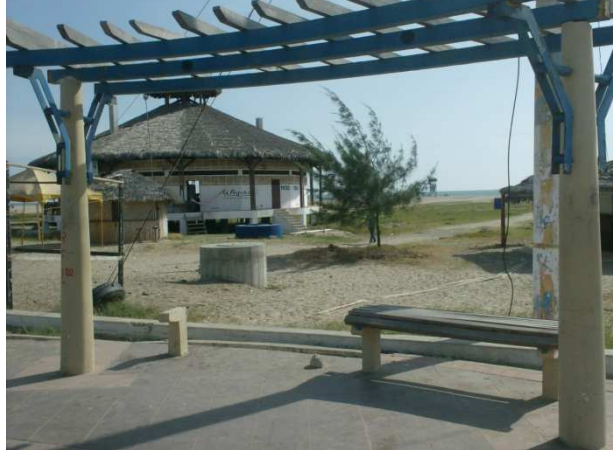
Foto 12. Estación de Bancas en Mal Estado
