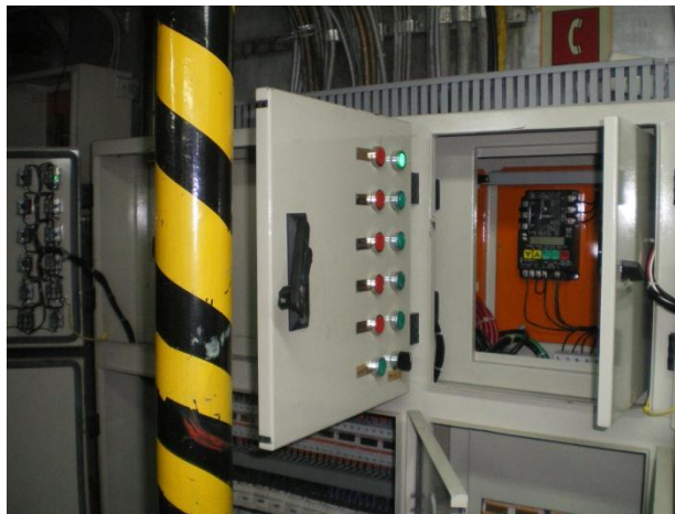
FIGURA 1.15 TABLERO ELECTRICO 220 AC SALAS DE MAQUINAS
