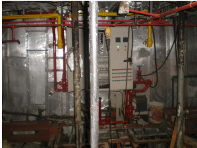
FIGURA 1.31 SALA DE MAQUINAS
