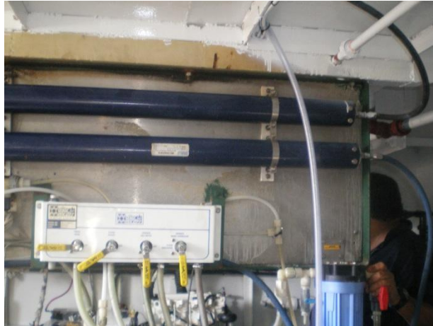
FIGURA 1.45 DESALINIZADORA WATERS MAKERS
