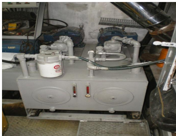
FIGURA 1.14 TANQUE Y SISTEMA HIDRAHULICO DE SERVOMOTOR
