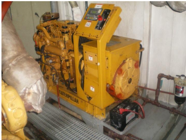
FIGURA 1.24 GENERADOR DE ESTRIBOR
