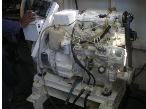
FIGURA 1.43 GENERADOR DE ESTRIBOR ISUZU 3LD1 1496L
