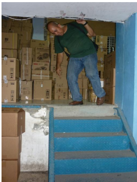
Figura 4.1.5 de las escaleras sin barandillas
