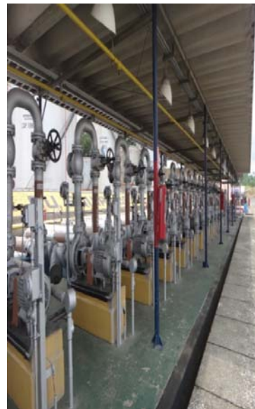
4.- Encender bombas de despacho.
