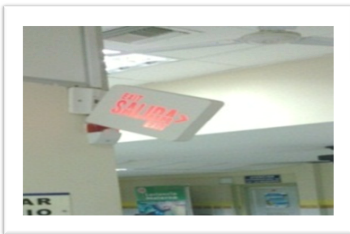
Figura 4.2 Señalética en mal estado Fuente: Maternidad
