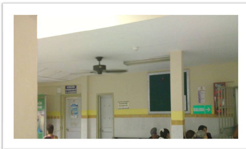
Figura 4.1 Ventilador en mal estado Fuente: Maternidad
