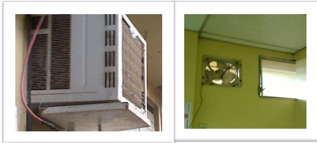
Figura 4.10 Ventilación y su respectivo mantenimiento
