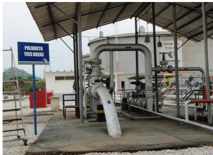
Figura 2.5.- Vista frontal del Poliducto 3B-P en la cota 0.0
