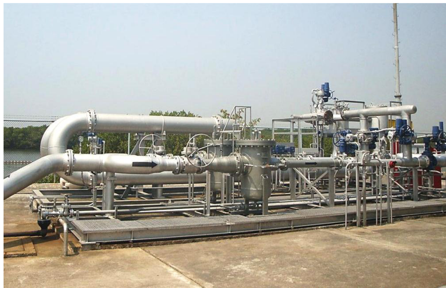
Figura 2.10.- Filtros y Medidor Másico de Caudal.
