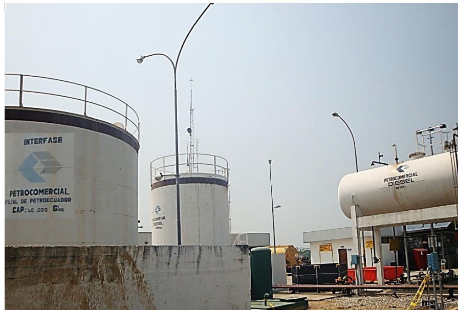
Figura 2.11.- Tanques de Almacenamiento de Combustibles Estación Tres Bocas.
