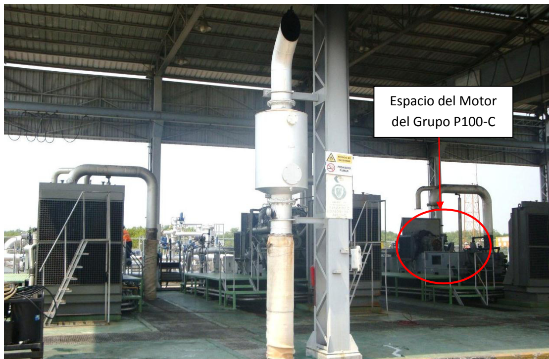
Figura 2.13.- Vista General de los grupos de bombeo
