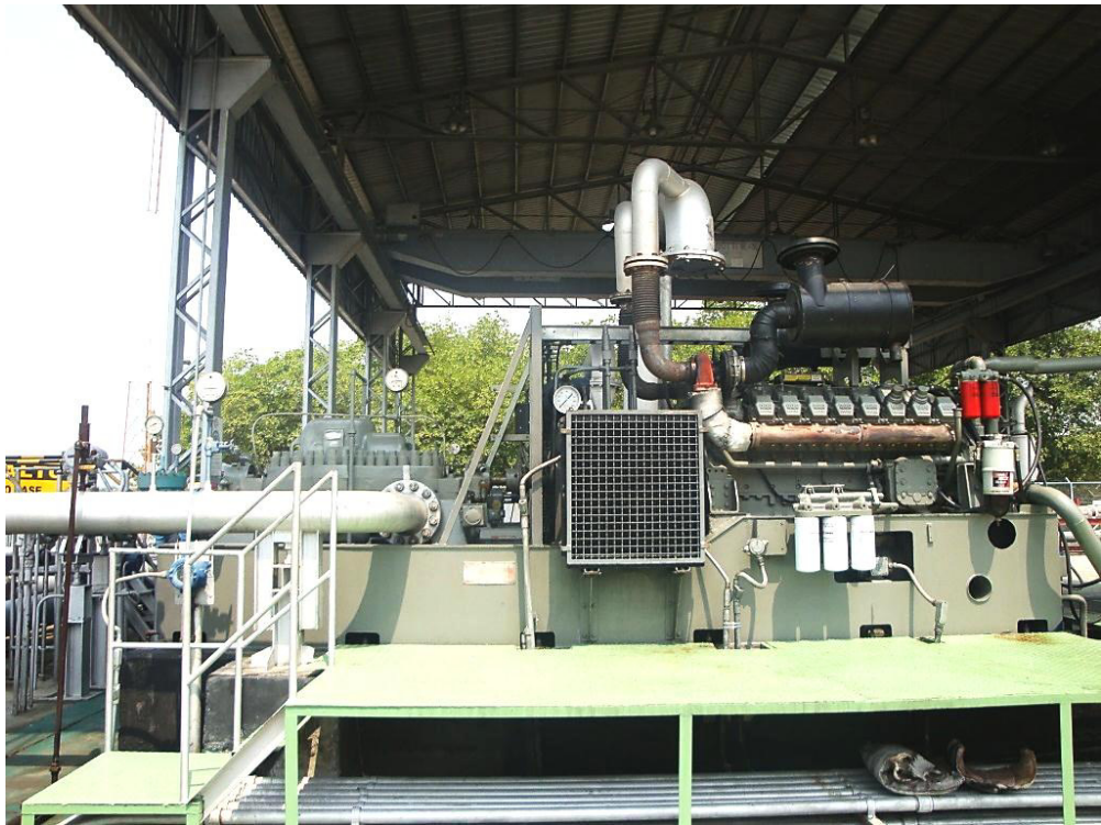
Figura 2.12.- Grupo de bombeo P100-A
