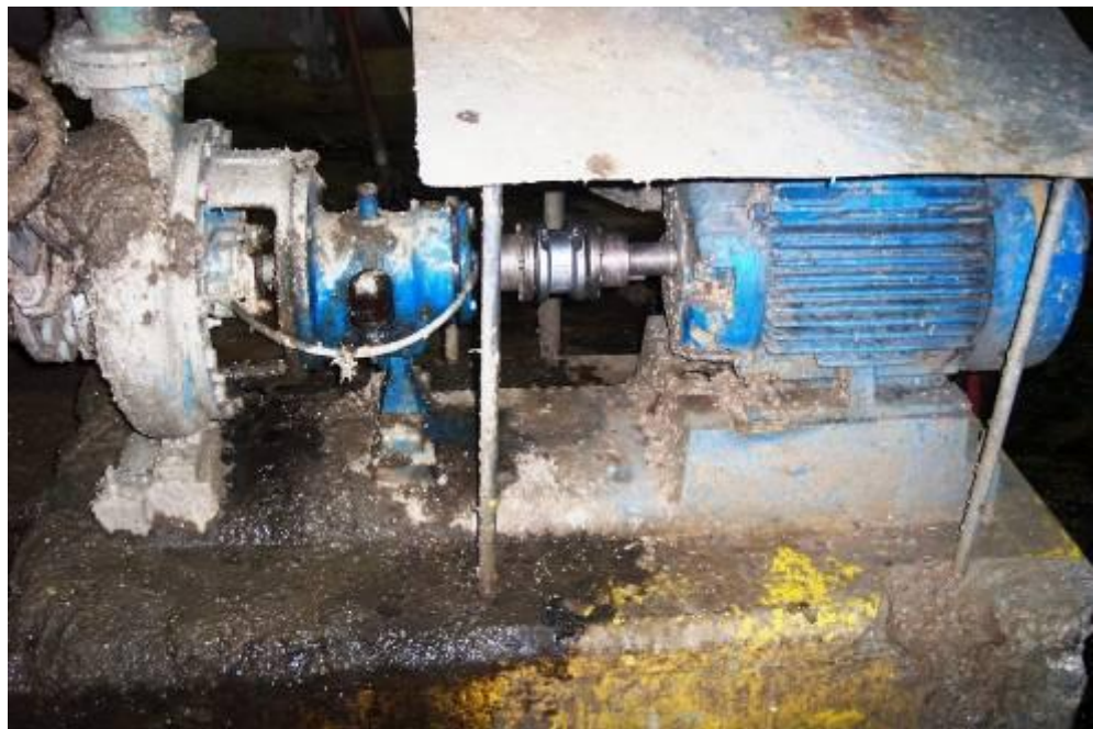
Figura N° 3.10: Ambiente de bomba P06, noviembre 2003.
