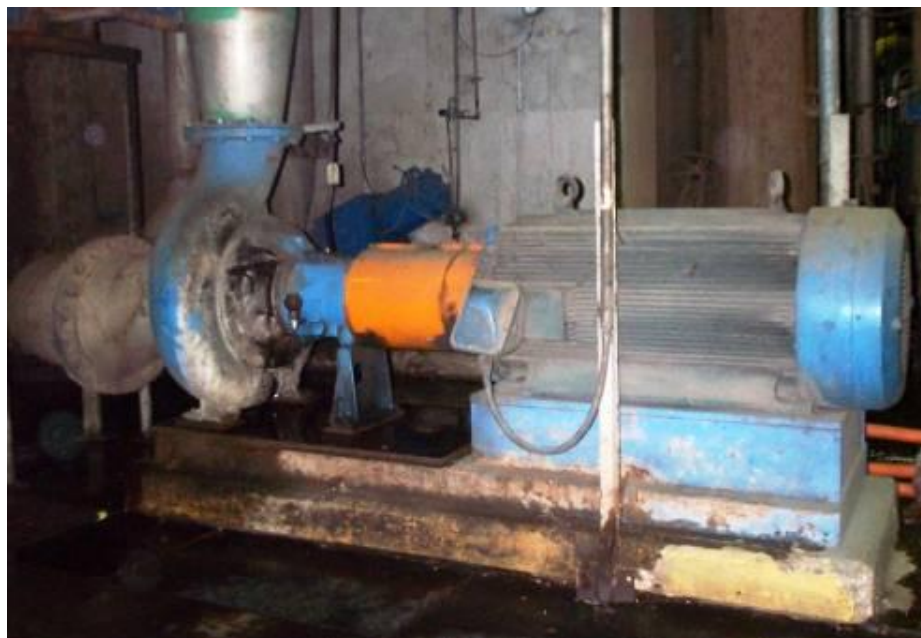
Figura N° 3.8: Ambiente de bomba P15 antes del Proyecto 2003.
