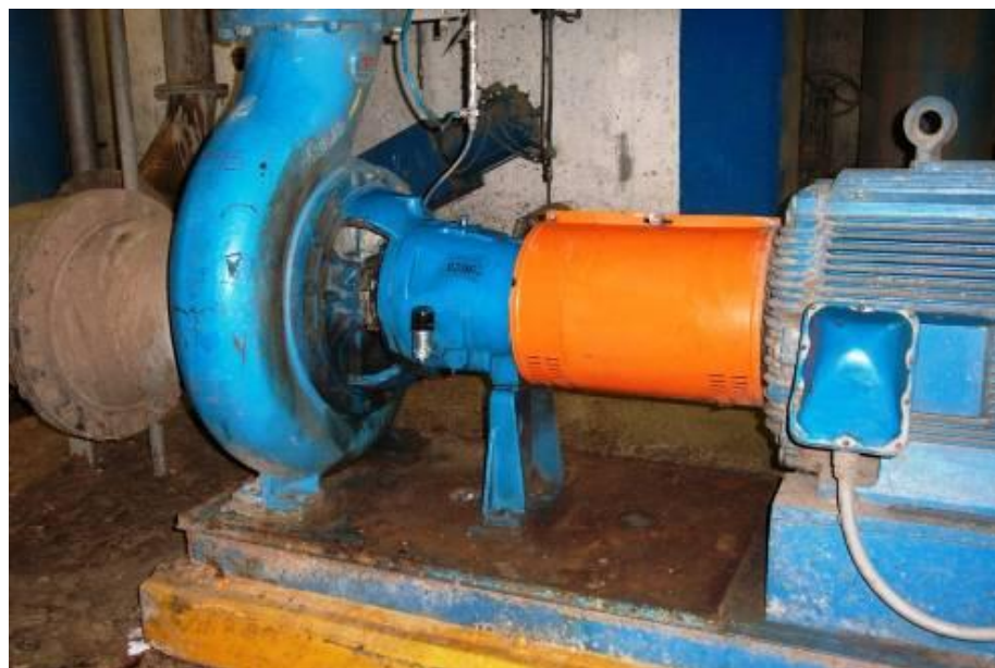
Figura N° 3.9: Ambiente de bomba P15 después 2006.
