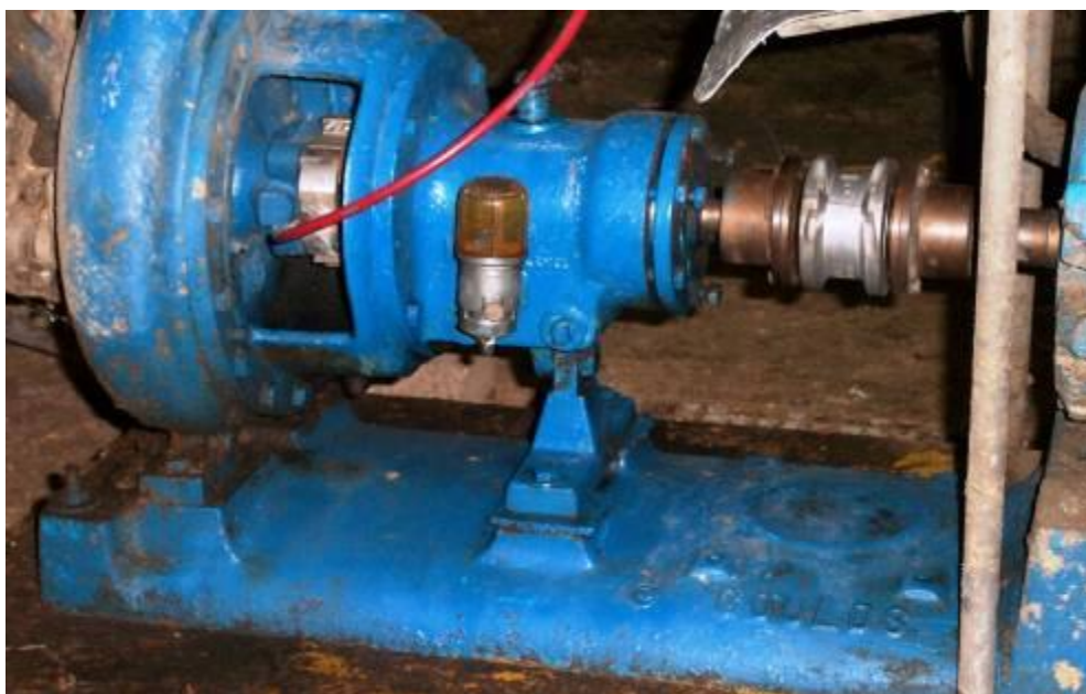
Figura N° 3.11: Ambiente de bomba P06, Julio 2006.
