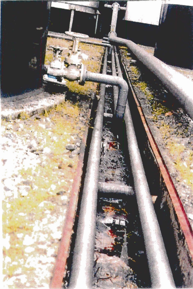
ografía # 3: Patio de tanques - Canal de tubería de productos.
