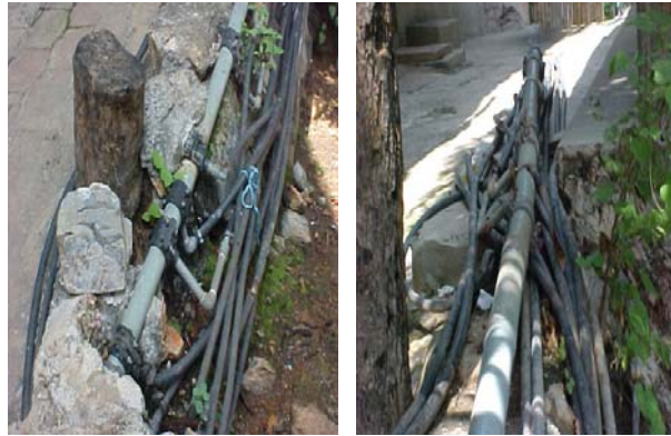
Foto 2 9no. Callejón, conexión ilegal de 30 mangueras de ½” a una tubería P.V.C de 2”.
