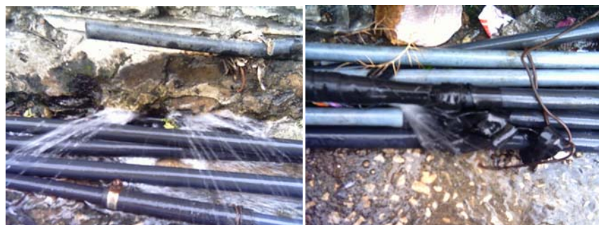
Foto 1 Callejón 12 de octubre, fugas visibles cada 2 m (roturas de mangueras)
