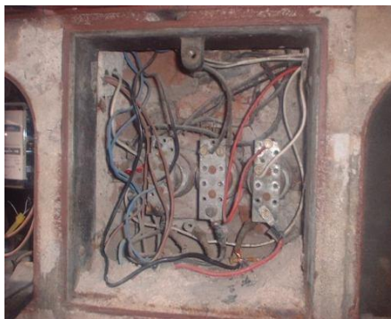
Fig.1. 5 Instalaciones eléctricas en malas condiciones
