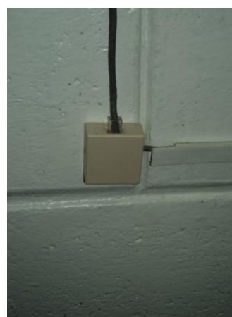
Figura 3. Dpto. Contabilidad Salida de Telecomunicaciones
