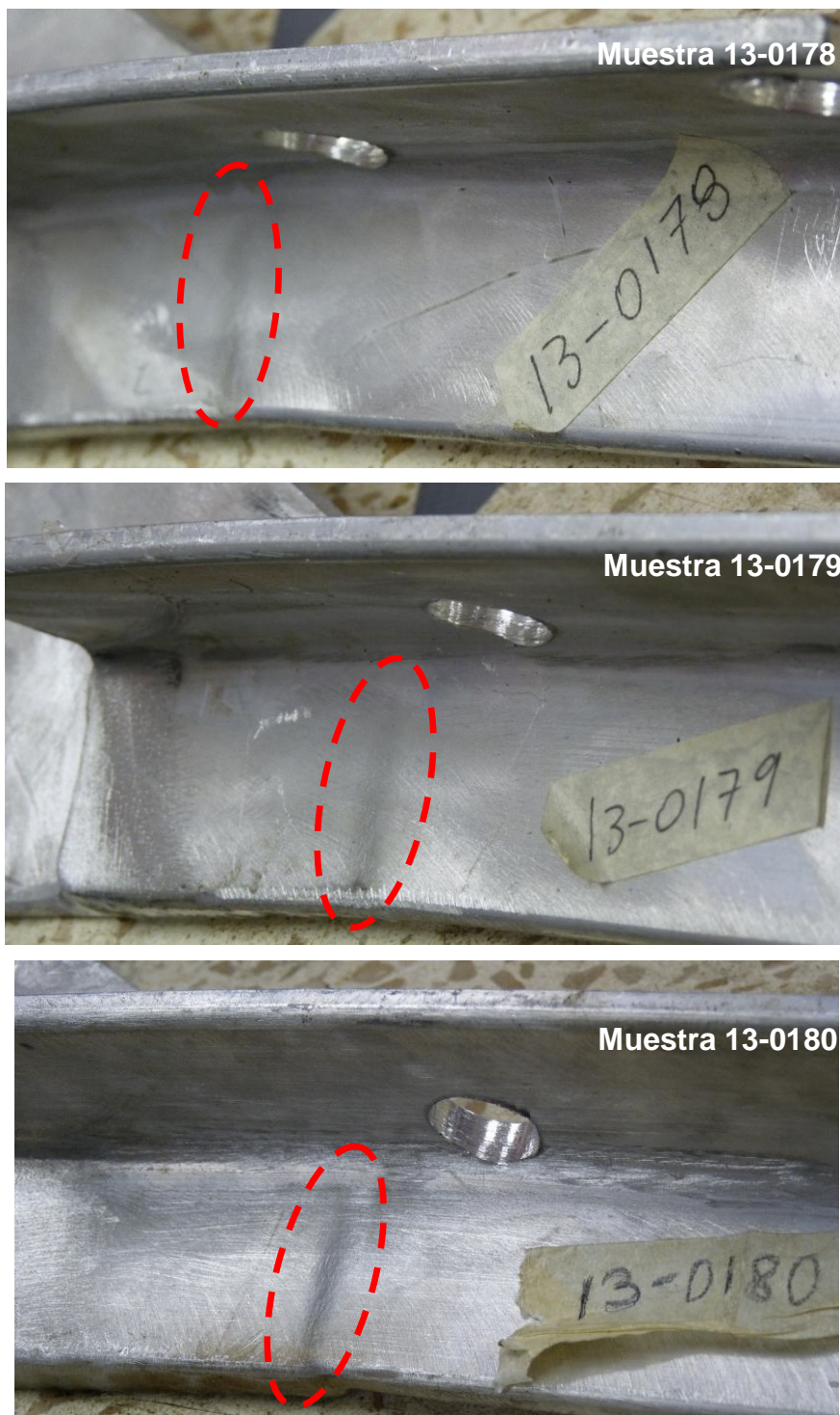
Figura No. 40 Fallas de las Conexiones Estructurales
