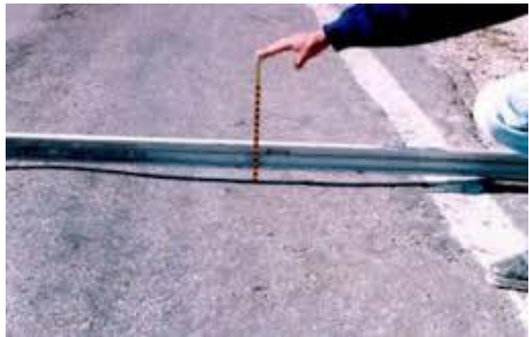
Gráfico 2.8. Roderas. Fuente: Catálogo de deterioro de pavimentos flexibles.
