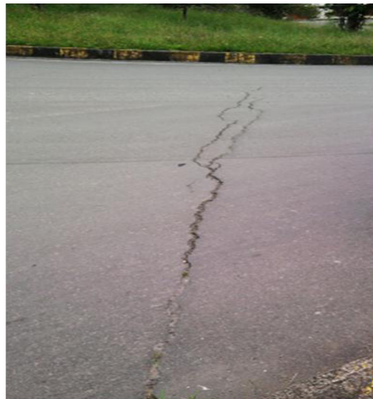
Gráfico 2.12. Grietas Transversales. Fuente: www.fsotelo5.blogspot.com/2011/inspeccion-de-danos-en-pavimentos-flexibles .
