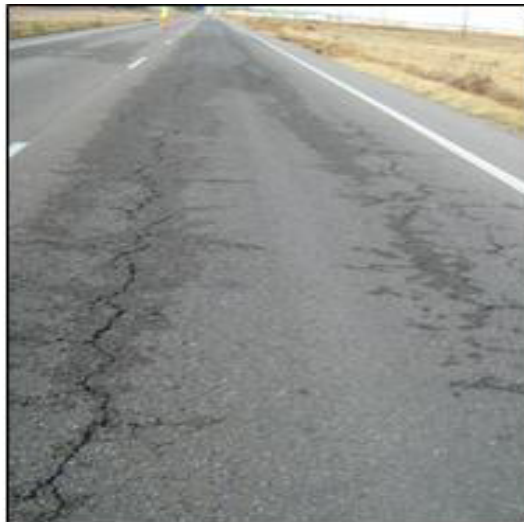
Gráfico 2.11. Grietas Longitudinales. Fuente: www.upm.es/institucional/UPM/CanalUPM/Noticias/ci .
