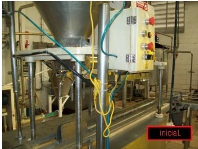
Fig.3.12. Panel eléctrico de llenadora
