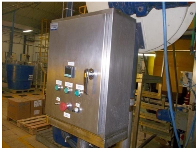
Fig.3.37. Panel de control de llenadora
