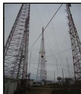
Figura 6.4. Antena Transmisor – Santa Elena.
