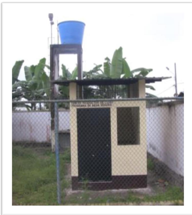
Figura # 9. Tanque elevado de agua potable con sistema de cloro
