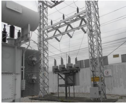
Fig 1 Transformador de Potencia de la S/E Samanes.
