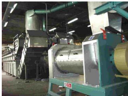
Figura 1°3 Línea de lavado y secado centrifugado.
