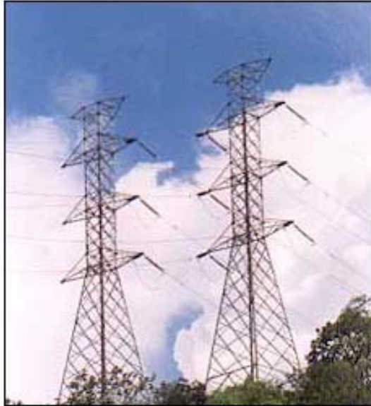
Figura 2-4 Torres de Distribución [15]
