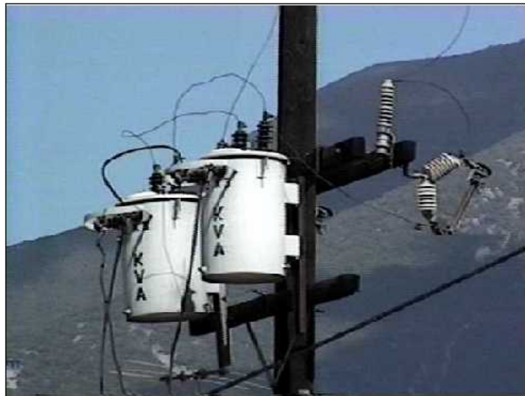
Figura 2-7 Foto del transformador tipo cilindro [19]
