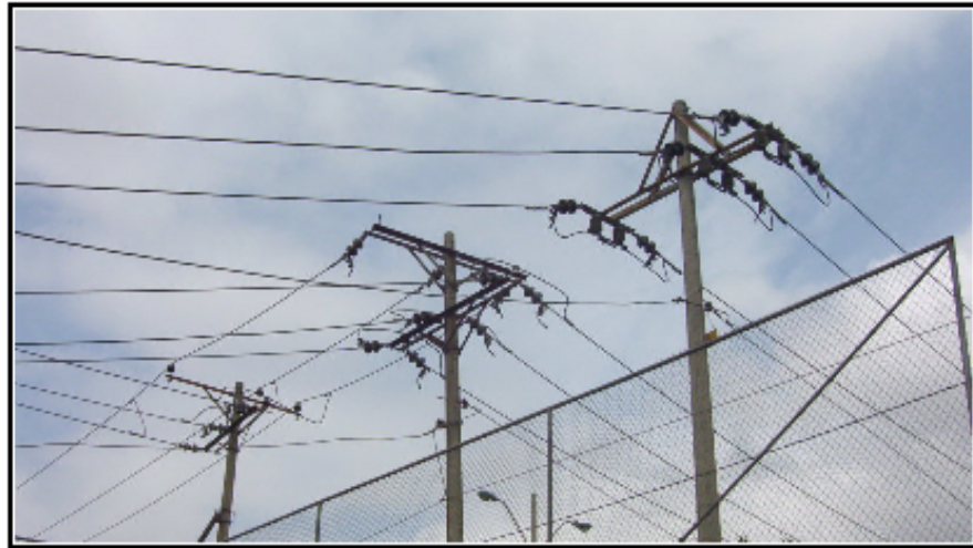
Figura 3-15 Redes eléctricas aéreas [37]
