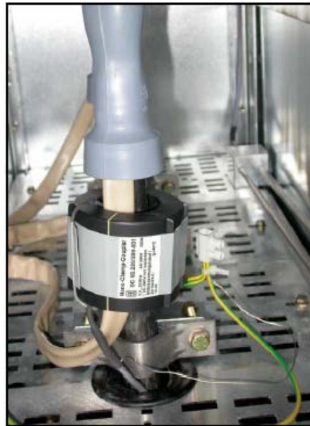
Figura 3-18 Acoplador inductivo para una línea de 300A(máx) [35]
