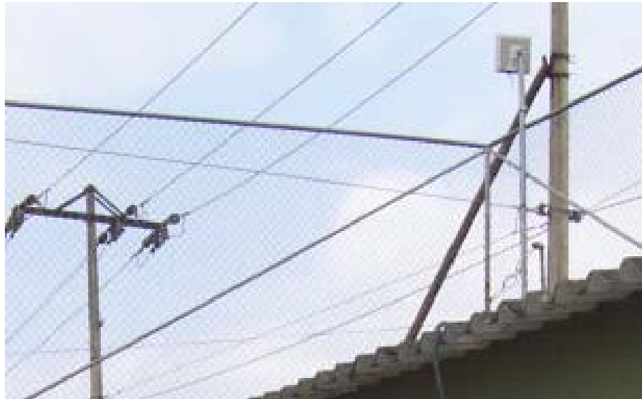
Figura 5-3 Antena instalada por la compañía ESPOLTEL dentro de la subestación eléctrica Garzota en la ciudad de Guayaquil [37].
