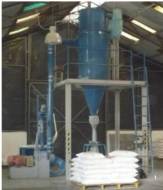
FIGURA 3.10. LÍNEA DE MOLIENDA DE AVENA
