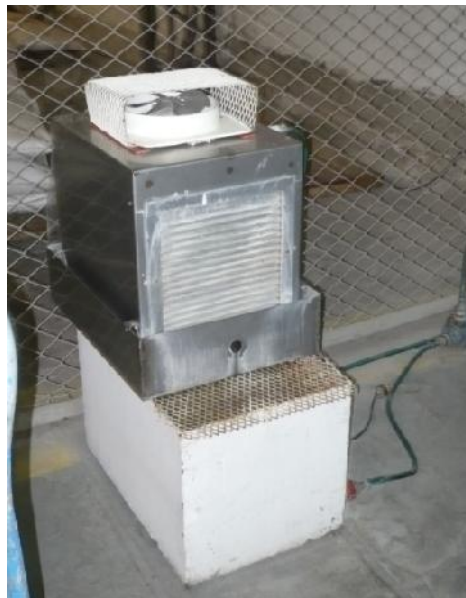
FIGURA 3.14. SISTEMA DE ENFRIAMIENTO
