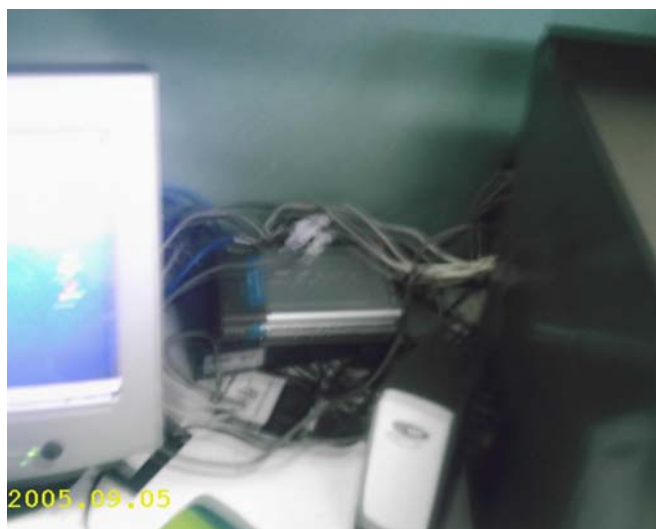
Figura 2.8. Switches Departamento Técnico TODO WIRELESS-SERVINET
