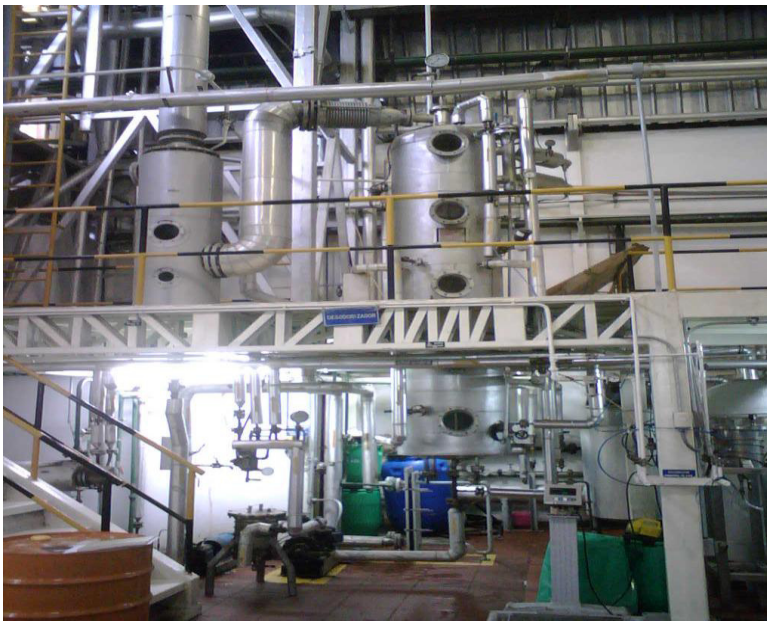
Imagen #1: Torres de destilación
