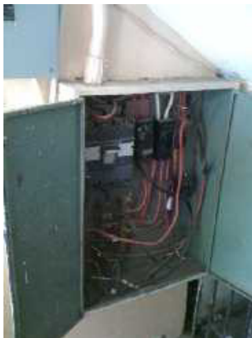
Ilustración 11 - Tablero eléctrico sin etiquetas de identificación
