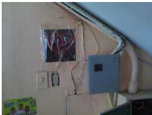
Ilustración 12 - Conexión eléctrica insegura sin tapa en la planta baja, en la escalera de ingreso al edificio
