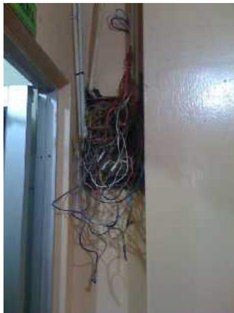
Ilustración 7 - Tablero eléctrico en mal estado
