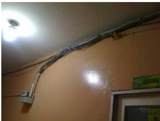
Ilustración 10 - Cableado eléctrico no cumple con normas de seguridad básicas
