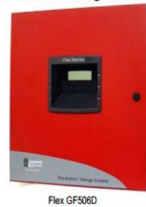
FIGURA 4.24 CENTRAL DE DETECCIÓN DE INCENDIOS
