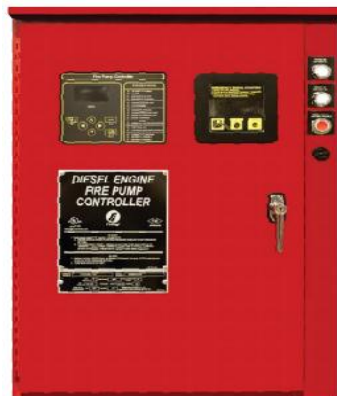
FIGURA 4.29 PANEL DE CONTROL PARA BOMBA MOTOR DIESEL
