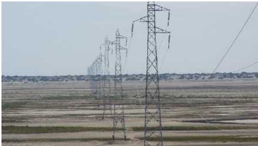
Gráfico 24 Detalle de la línea de transmisión de 138kV
