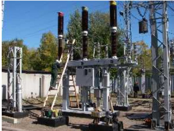
Gráfico 31 Interruptores de Potencia
