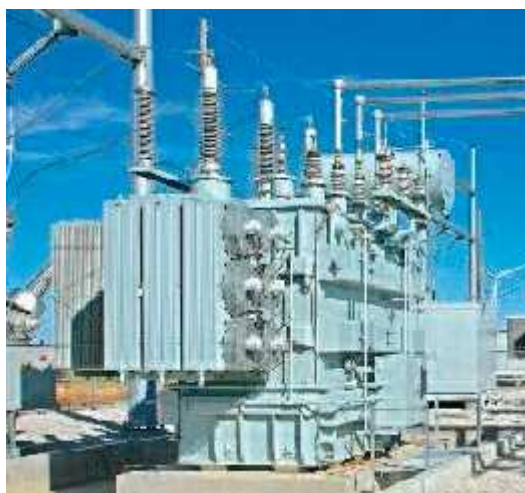
Gráfico 29 Transformador de Potencia 150MVA
