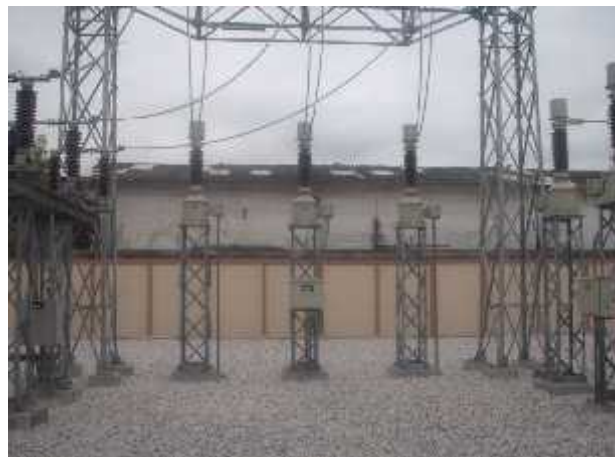
Gráfico 34 Transformadores de Potencial
