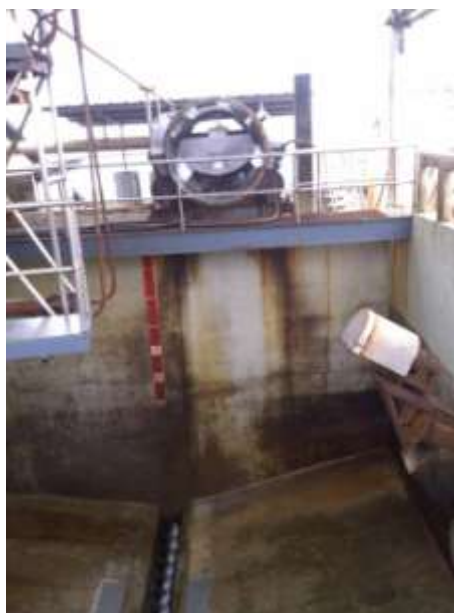
Figura 3.4 Pozos de recepción
