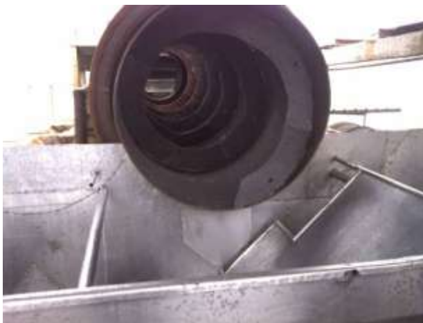
Figura 3.3 Tubería de descarga hacia las tolvas de recepción
