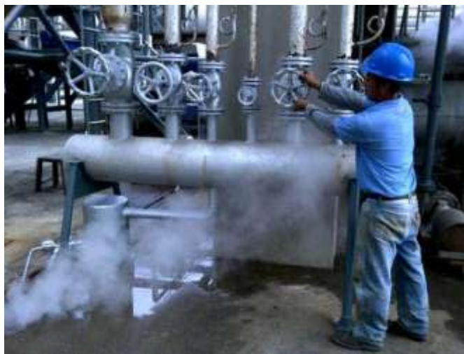
Figura 3.14 Fugas presentadas en las válvulas principales.
