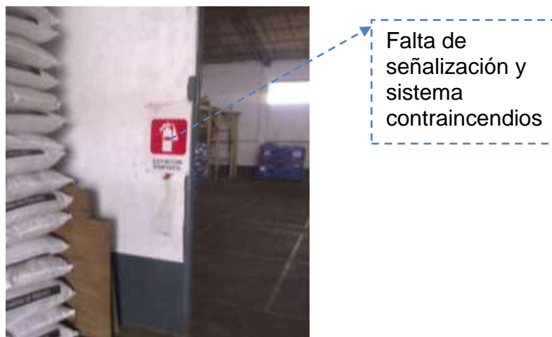
Figura 3.18 Falta de sistema contra incendio y seguridad en bodega
