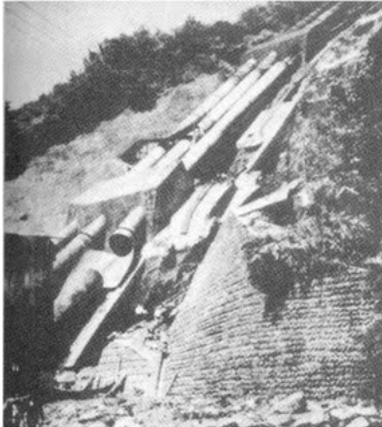
FIGURA 2.11 TUBERÍA DE PRESIÓN ROTA DE CENTRAL OIGAWA, JAPÓN. Fuente: EBASCO SERVICES Inc., New York.
