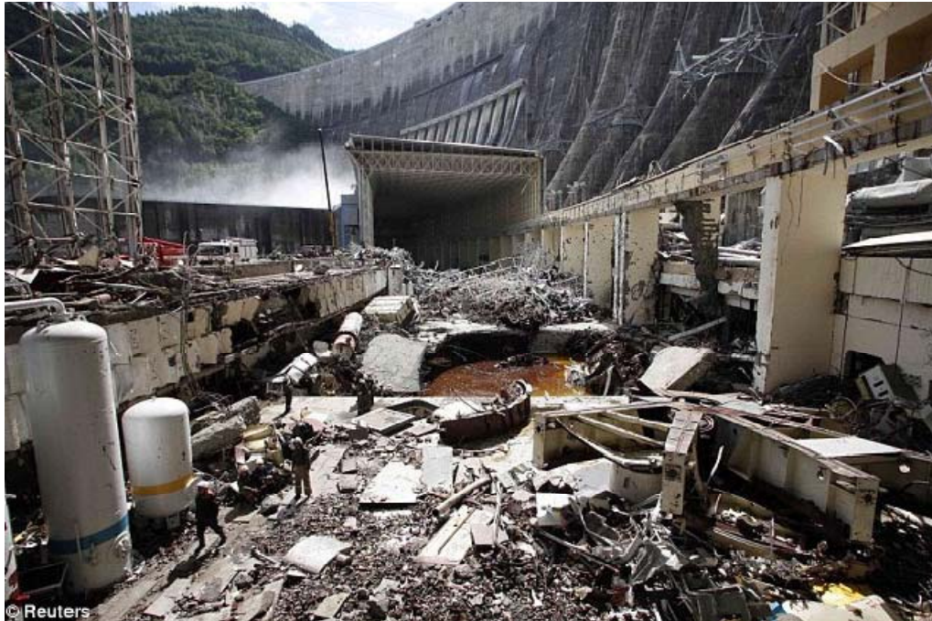
FIGURA 2.12 CASA DE MÁQUINAS DESTRUIDA EN CENTRAL SOYANO SHUSHENSKAYA, RUSIA. Fuente: RT NOTICIAS.
