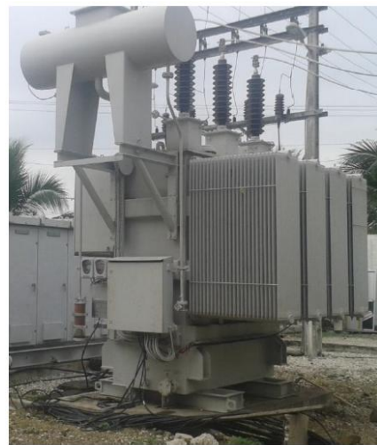
Figura 2. Transformador de Potencia Instalado
