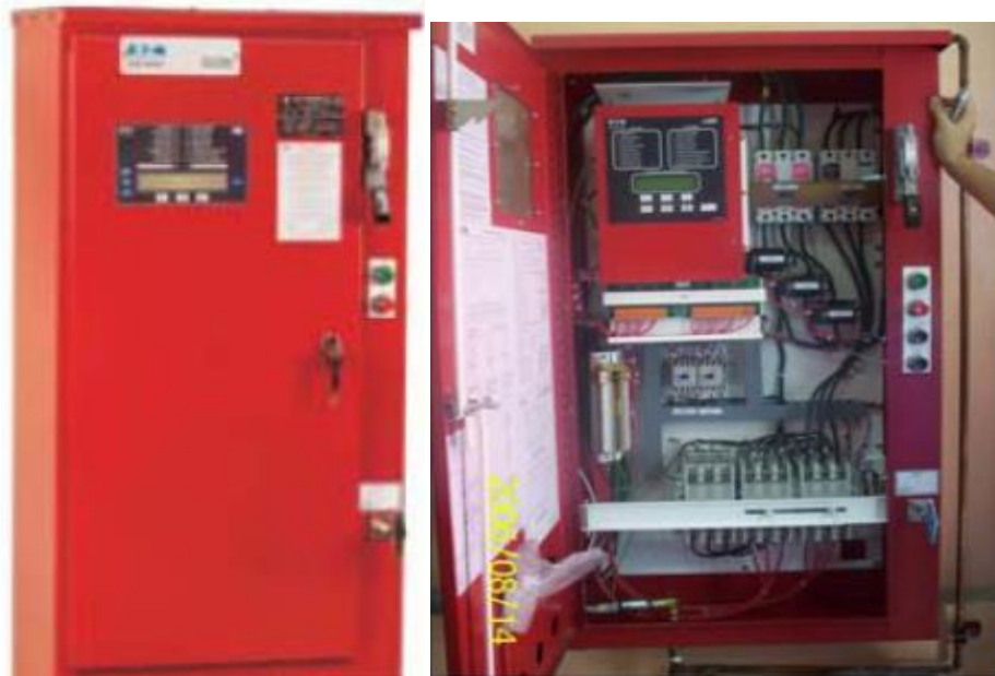
FIGURA 3.7 TABLERO DE CONTROL DE MOTOR ELÉCTRICO
