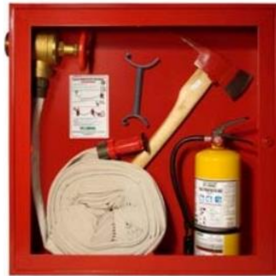
FIGURA 2.10 B0CA DE INCENDIO EQUIPADA (GABINETE)
