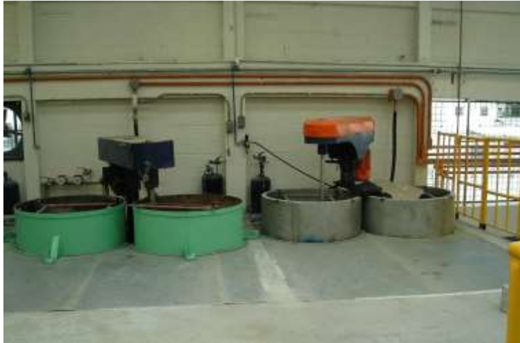
FIGURA 6.1 FOTO DEL ÁREA DE REDUCCIÓN DESPUÉS DE 5S
