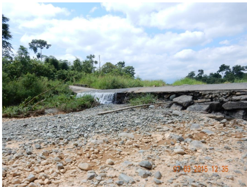
Fotografía 20.- Socavación aguas abajo del Dique Tomado por el autor
