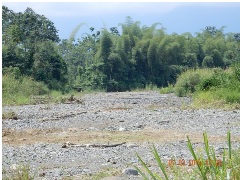
Fotografía 19.-Acumulación de sedimentos aguas arriba del Dique Tomado por el autor
