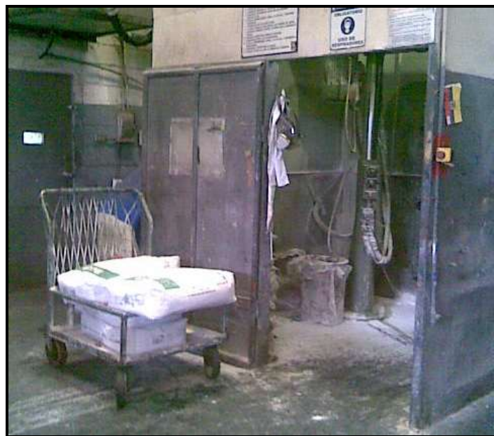
Figura 5.15 Cámara de mezcla sin palet de PVC a la entrada
