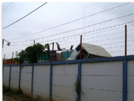
FIGURA 3.9 ALTURA INADECUADA DE LAS BARRERAS
