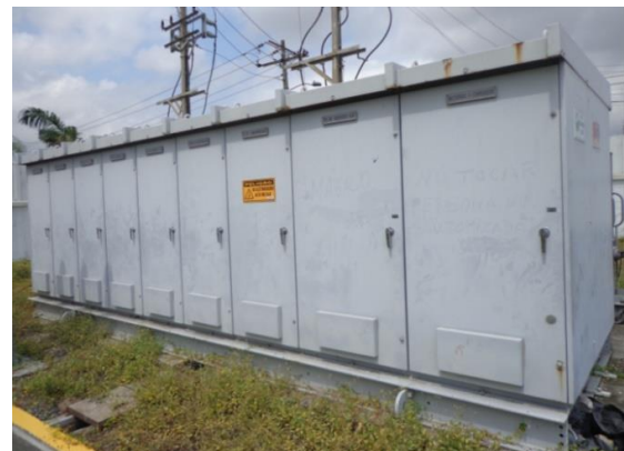
Figura 4. Armarios de la Subestación Durán Norte.
