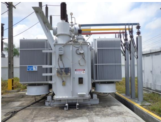
Figura 3 Transformador de Potencia de la S/E Durán Norte
