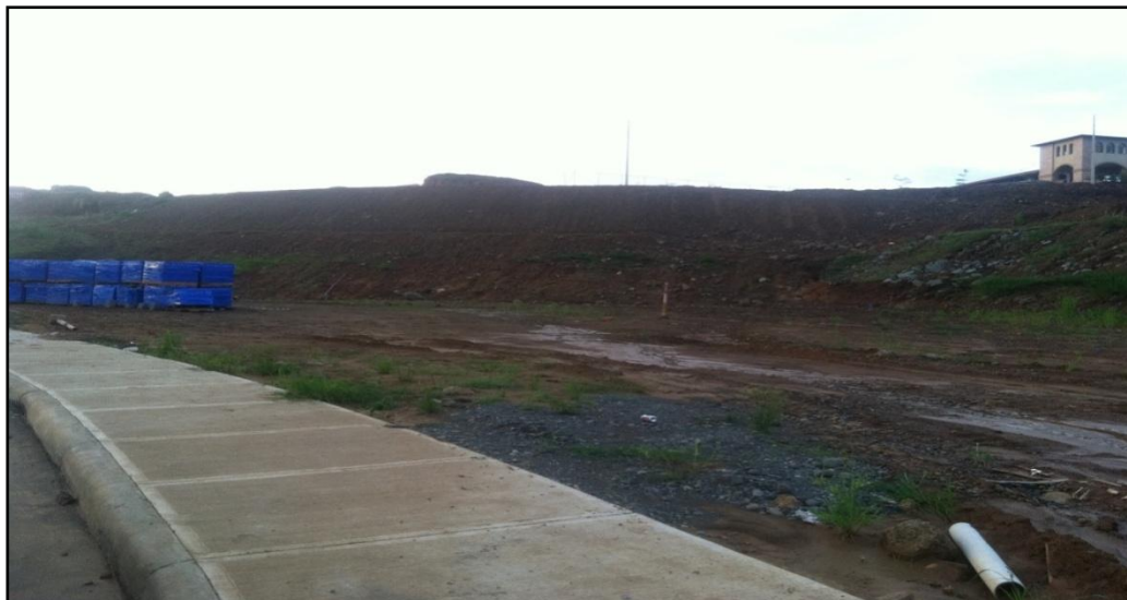
Foto 7.3.- Foto de una zona de excavación y taludes sin estabilizar, propensa a deslizamiento, La Joya etapa Opalo. Fuente: Autores, Agosto 2015.
