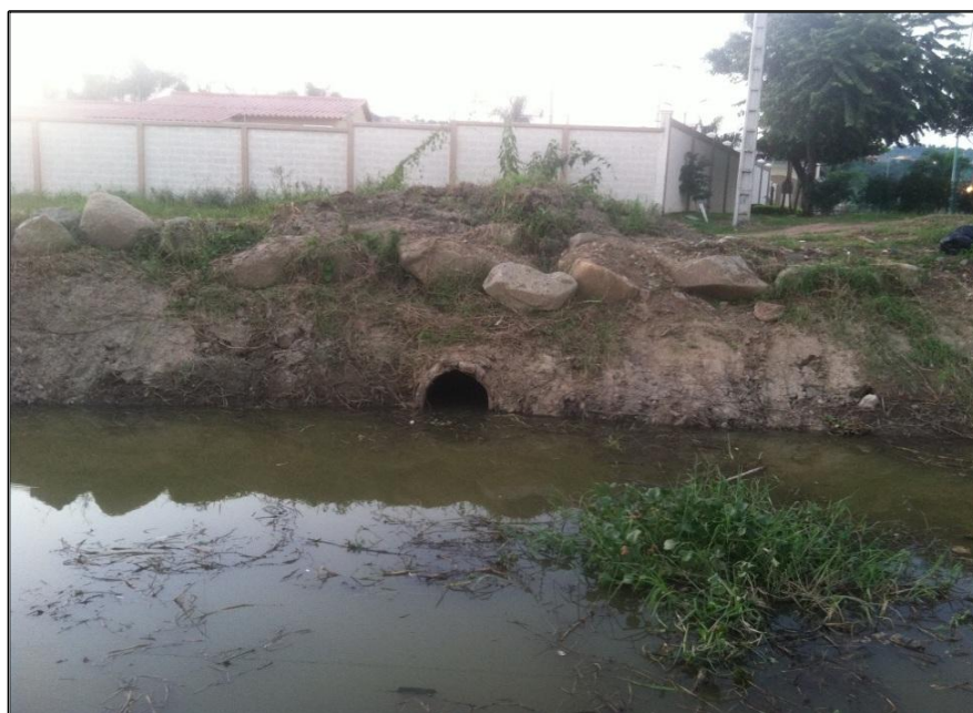
Foto 1.4.- Canal azolvado, nótese la presencia de un tubo de descarga lateral hacia el canal. Fuente: Autores, Junio 2015.
