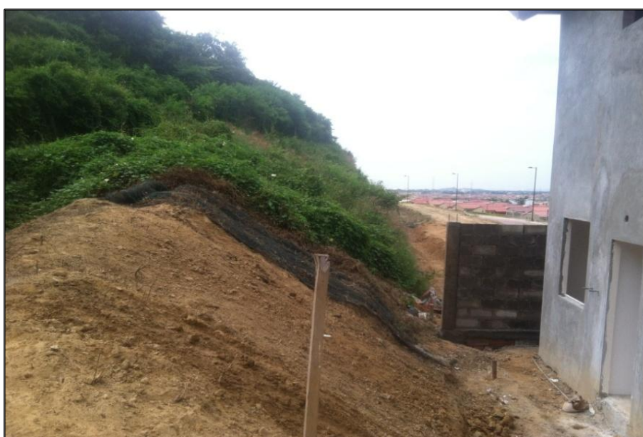
Foto 7.8.- Vivienda construida junto a un talud sin estabilizar. Fuente: Autores, Agosto 2015.
