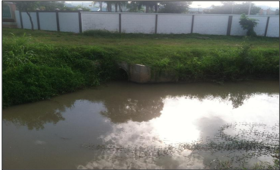
Foto 1.2.- Canal de evacuación de agua lluvia estancada. Fuente: Autores, Junio 2015.
