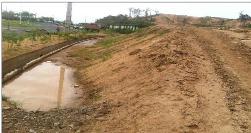
Foto 7.12.- Fotografía de charcos de agua empozada al pie de un talud por operaciones de excavación. Fuente: Autores, Agosto 2015.
