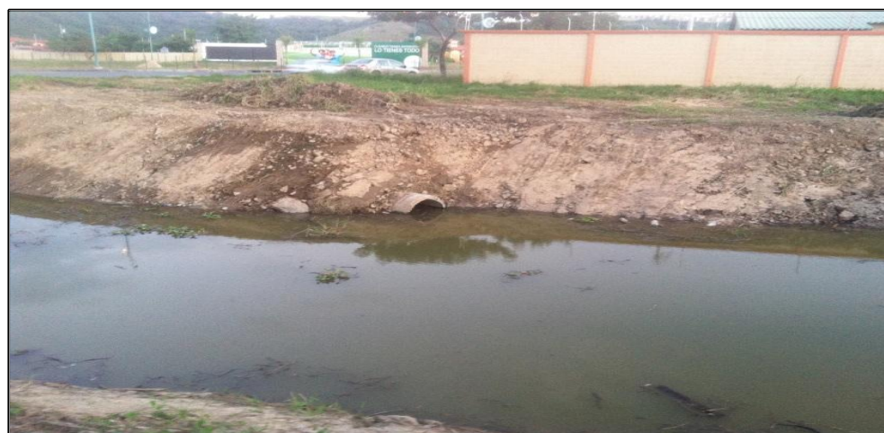
Foto 7.13.- Canal con agua estancada, generación de malos olores y criadero de mosquitos. Fuente: Autores, Agosto 2015.
