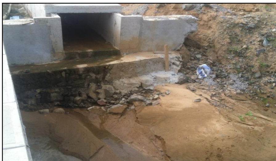
Foto 7.7.- Material erosionado saliendo del alcantarillado pluvial. Fuente: Autores, Agosto 2015.
