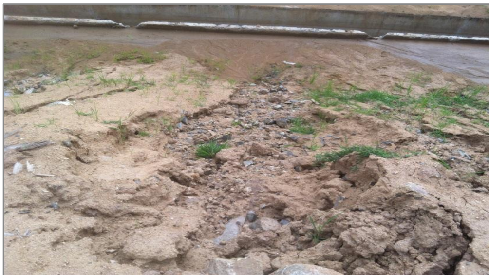
Foto 7.10.- Deslizamiento de material erosionado hacia las calles de la urbanización. Fuente: Autores, Agosto 2015.
