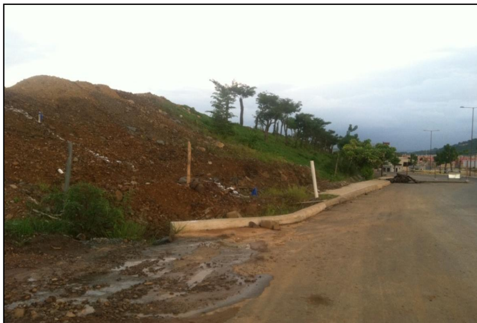
Foto 7.2.- Se aprecia como el material erosionado invade las cunetas, reduciendo la capacidad de desagüe de las mismas. Fuente: Autores, Agosto 2015.
