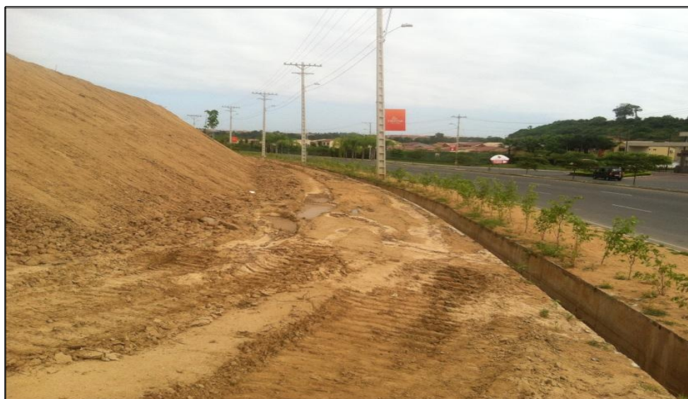
Foto 7.9.- Zona de excavación en donde se puede apreciar como el material erosionado esta esparcido a lado de la zanja de drenaje. Fuente: Autores, Agosto 2015.
