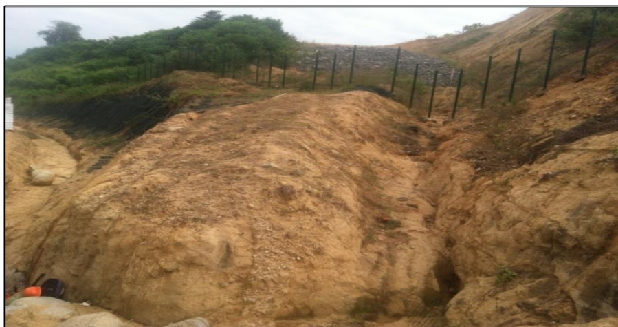
Foto 7.6.- Talud rocoso con peligro de deslizamientos por fatal de estabilización. Fuente: Autores, Agosto 2015.
