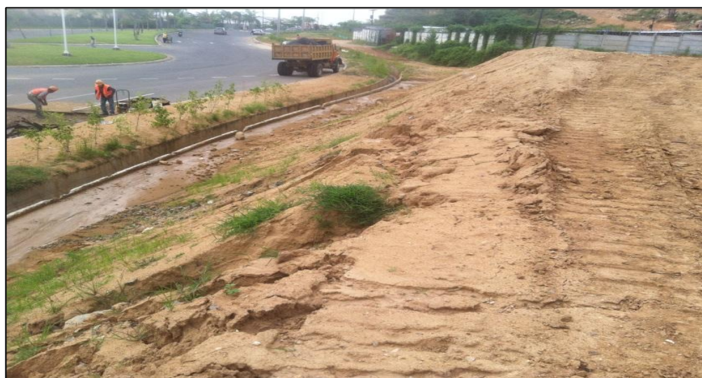
Foto 7.11.- Talud erosionado por las operaciones constructivas de la urbanización. Fuente: Autores, Agosto 2015.
