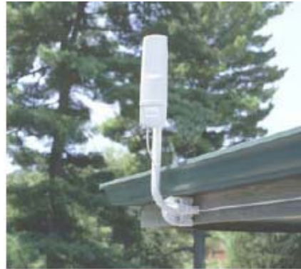
Figura 5.3: CPE montado en estructura
