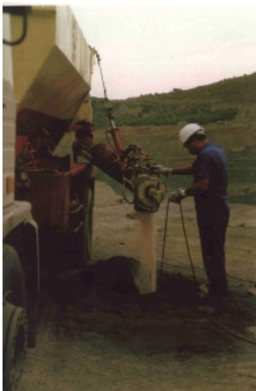
Figura 1.5 Camión de Nagolita en labores de carga de barrenos de gran calibre (Cortesía UEE, S.A.)
