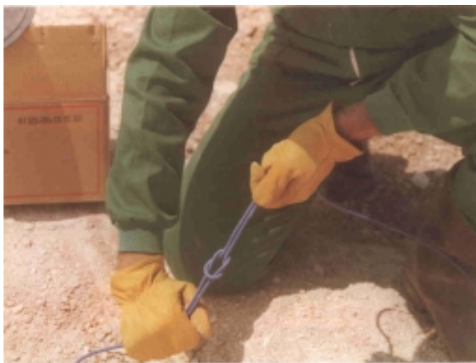
Figura 1. 28 Nudo de conexión entre ramales de cordón detonante (Cortesía de UEE, S.A.)
