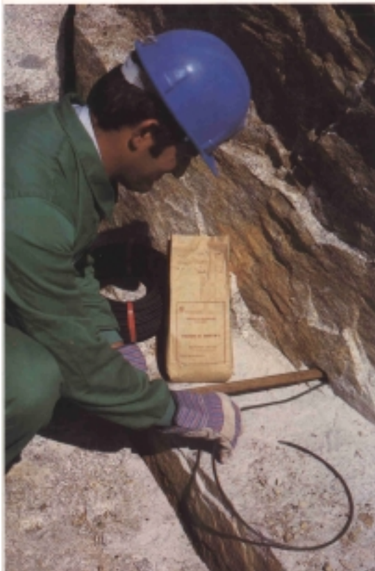
Figura 1. 12 Carga de barrenos para extracción de rocas ornamentales mediante pólvora de mina y mecha lenta (Cortesía de UEE, S.A.)
